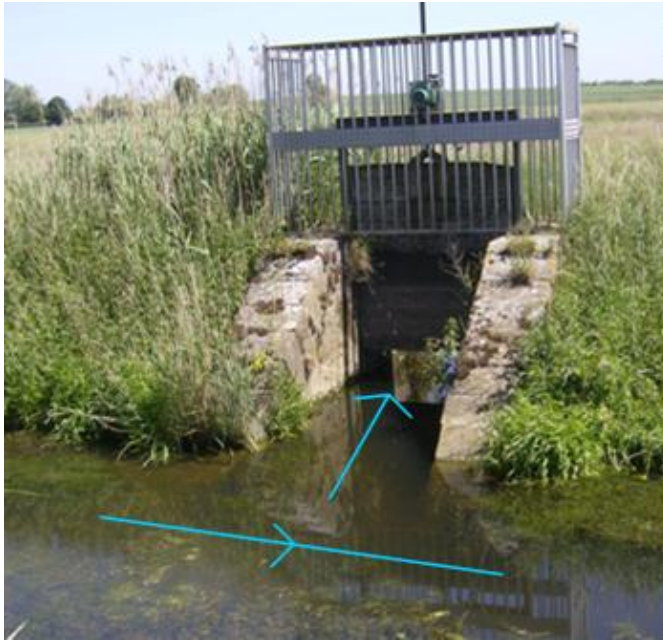
Vanne manuelle le long de la Melde du Nord
