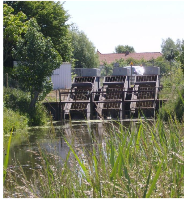
Station de pompage à l'exutoire de la Melde du Nord
