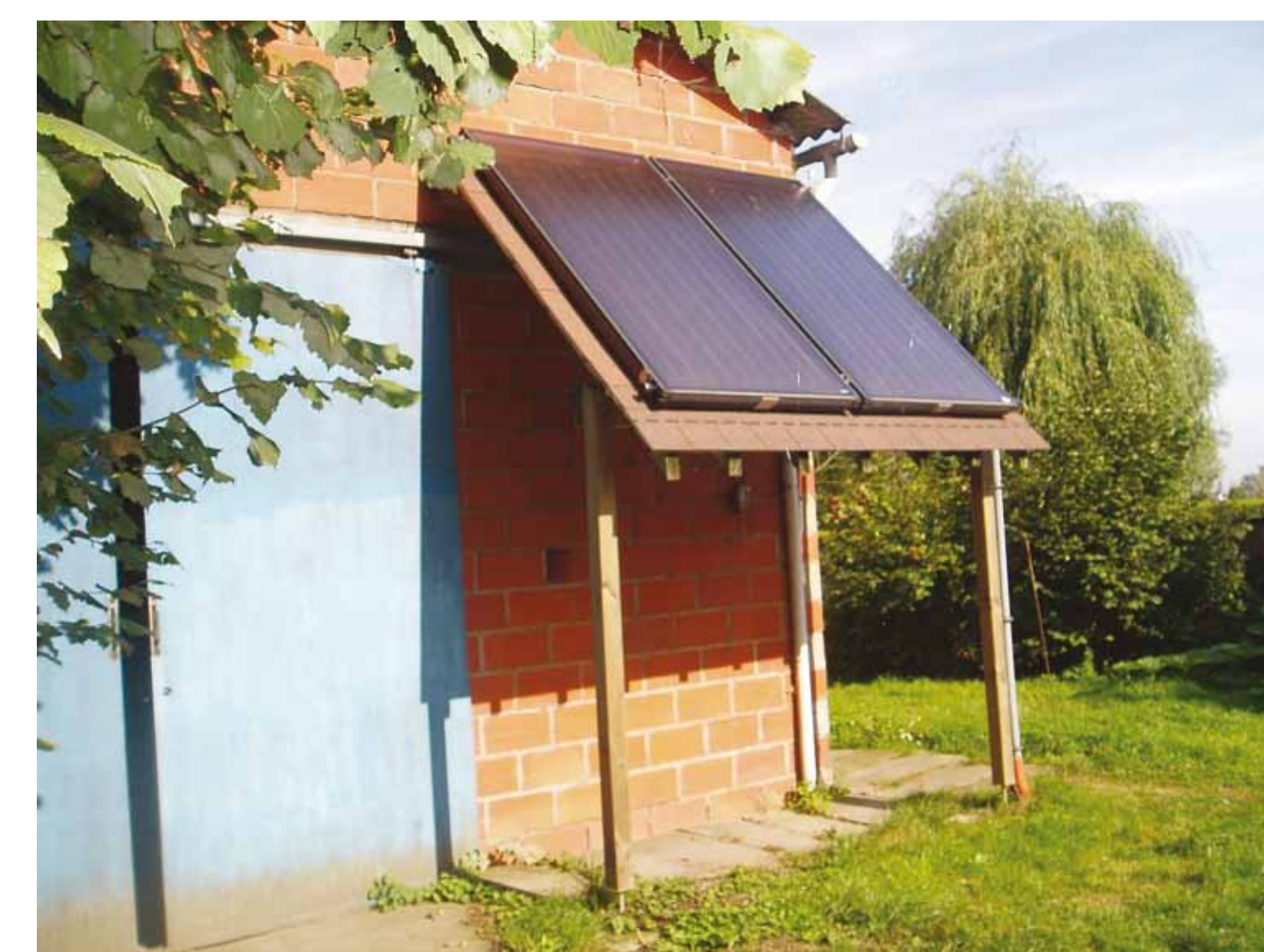
Panneaux solaires thermiques - chez un particulier - Photo A. Vaillant
